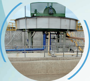
Tratamiento de aguas residuales municipales
