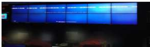
▼ Network Operations Center (NOC) en Managua de un ISP, Videowall de 12 pantallas Matriz de 6 x 2 (14.28 mts2) equipos LG
