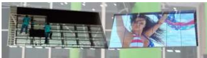
▼ Digital Signage Samsung, Mall Galerías Nicaragua Videowall de 36 pantallas Matriz de 6 x 6 (30 mts2)
