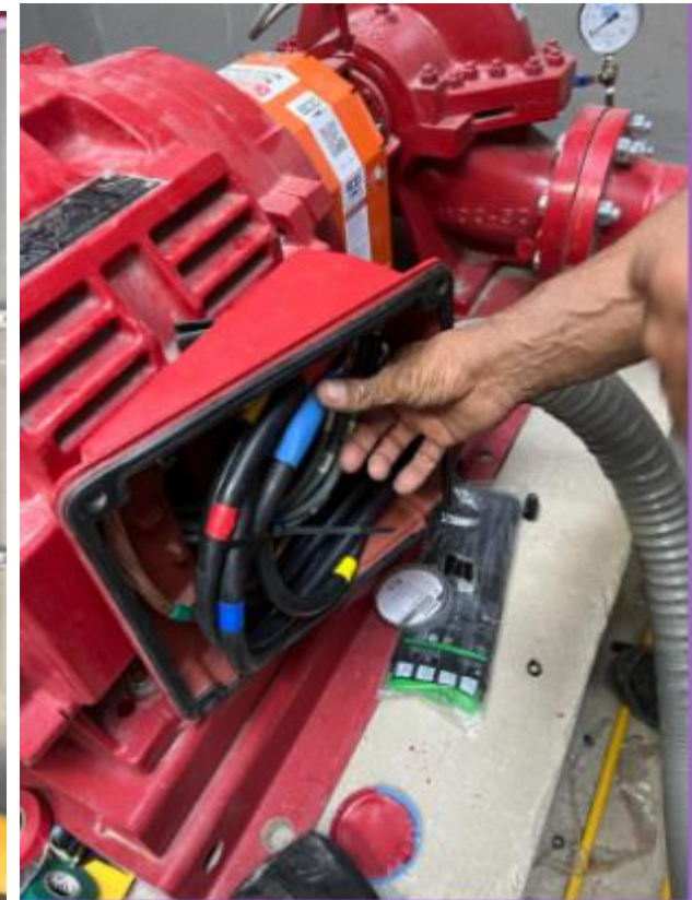
Cableado Bomba contraincendios
