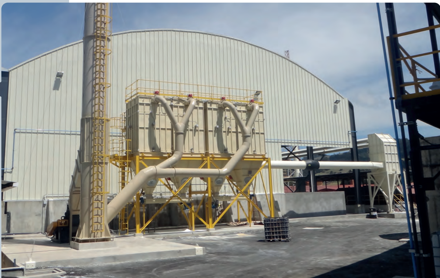
Control de emisiones en horno
