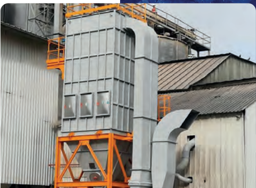
Control de polvo en estación de recibo
