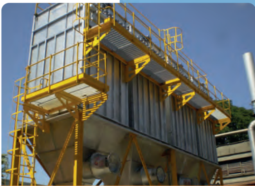
Control de emisiones en caldera
