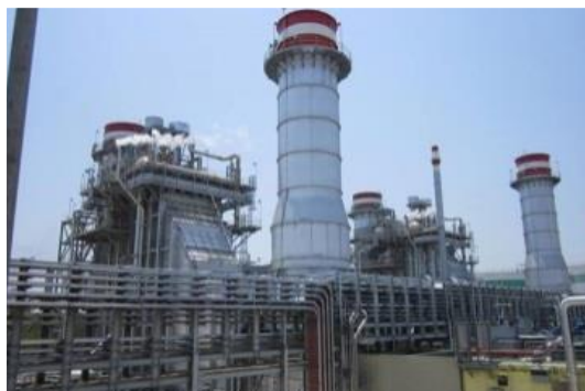
Ciclos Combinados y Termoeléctricas
