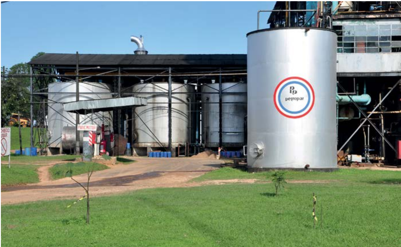
Tanques Verticales para Almacenamiento - PETROPAR Vertical Storage Tank - PETROPAR Tanques Verticais para Armazenamento - PETROPAR 巴拉圭石油公司 - 直立式儲存罐
