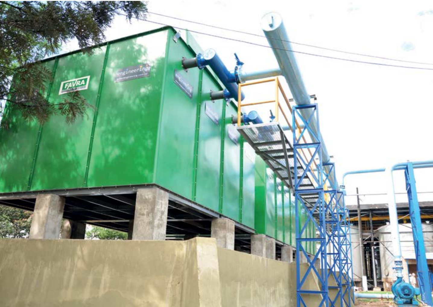
Sistema de Refrigeración de Agua Industrial por Torres de Enfriamiento - PETROPAR Industrial Water Cooling System by Cooling Towers - PETROPAR Sistema de Refrigeração de Água Industrial por Torres de Esfriamento - PETROPAR PETROPAR - 工業用水降溫塔冷卻系統
