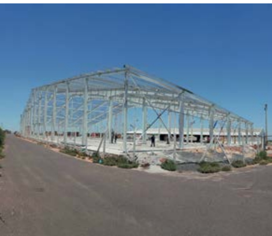
Celda de Almacenamiento - PTP GROUP PARAGUAY S. A. Storage Cell - PTP GROUP PARAGUAY S. A. Cela de Armazenamento - PTP GROUP PARAGUAI S. A. PTP GROUP Paraguay S. A.公司 - 獨立儲存單位
