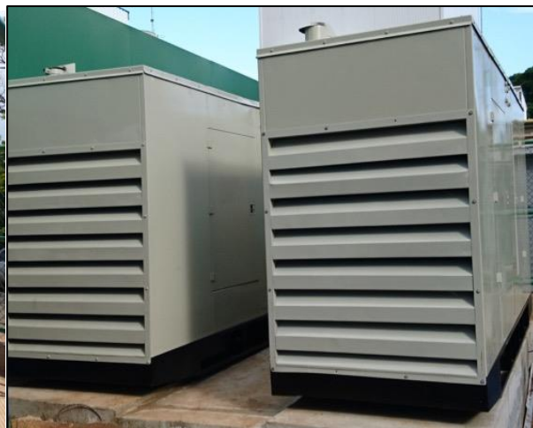
Área dos Geradores: 20m 2
