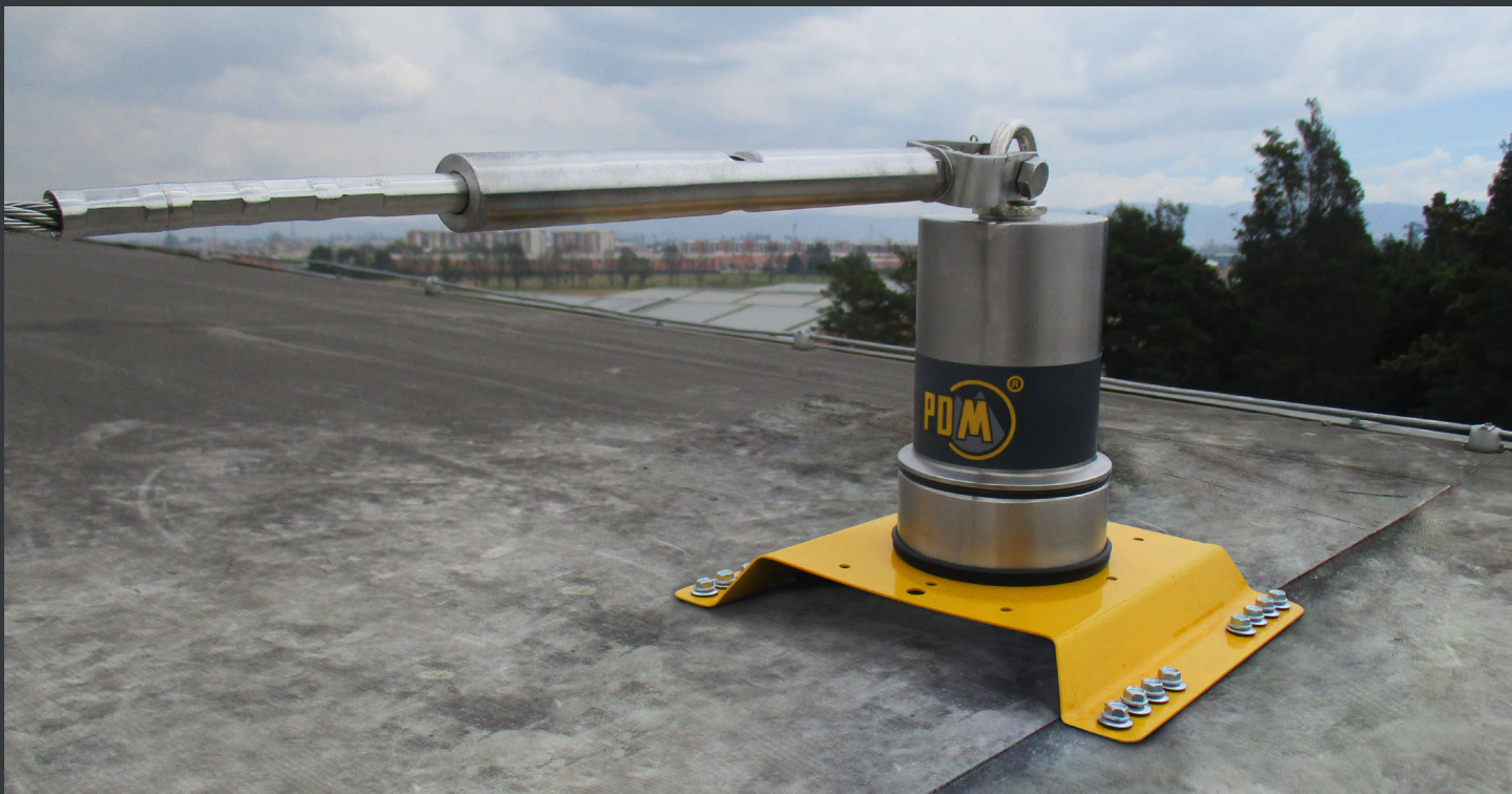
PDM como extremo de línea de vida horizontal instalado en Purina, Mosquera, Cundinamarca, Colombia.
