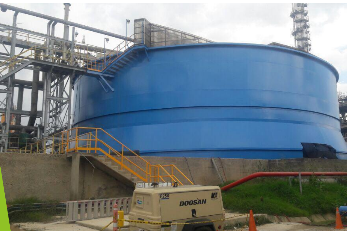
TANQUES DE ALMACENAMIENTO
