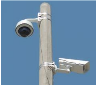
Cámara de Video y Tráfico
