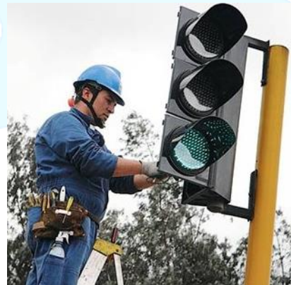
Semáforo vehicular led de 3 luces
