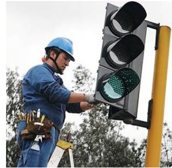
Semaforización & Sistemas de Tráfico
