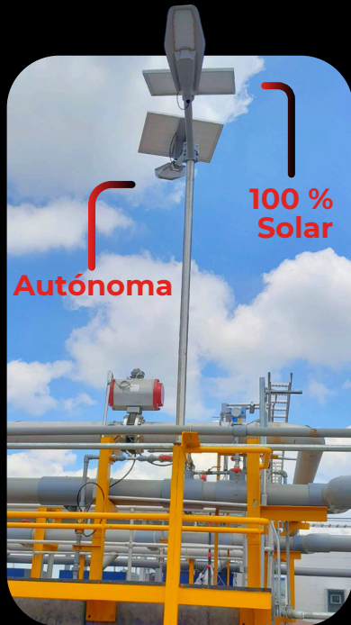
DANONE ALUMBRADO PÚBLICO SOLAR
