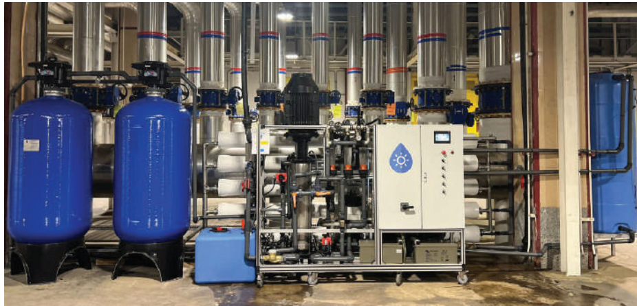
Sistema de desalinización solar de agua, sur de Irak, 50m 3 /h, paneles solares de 120 kWp
