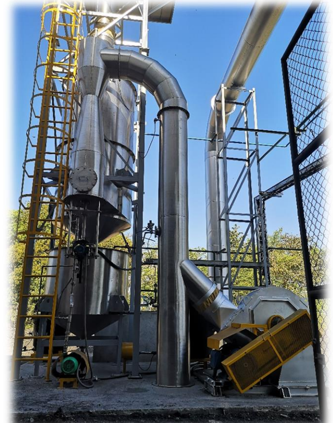
Lavadores de gases
