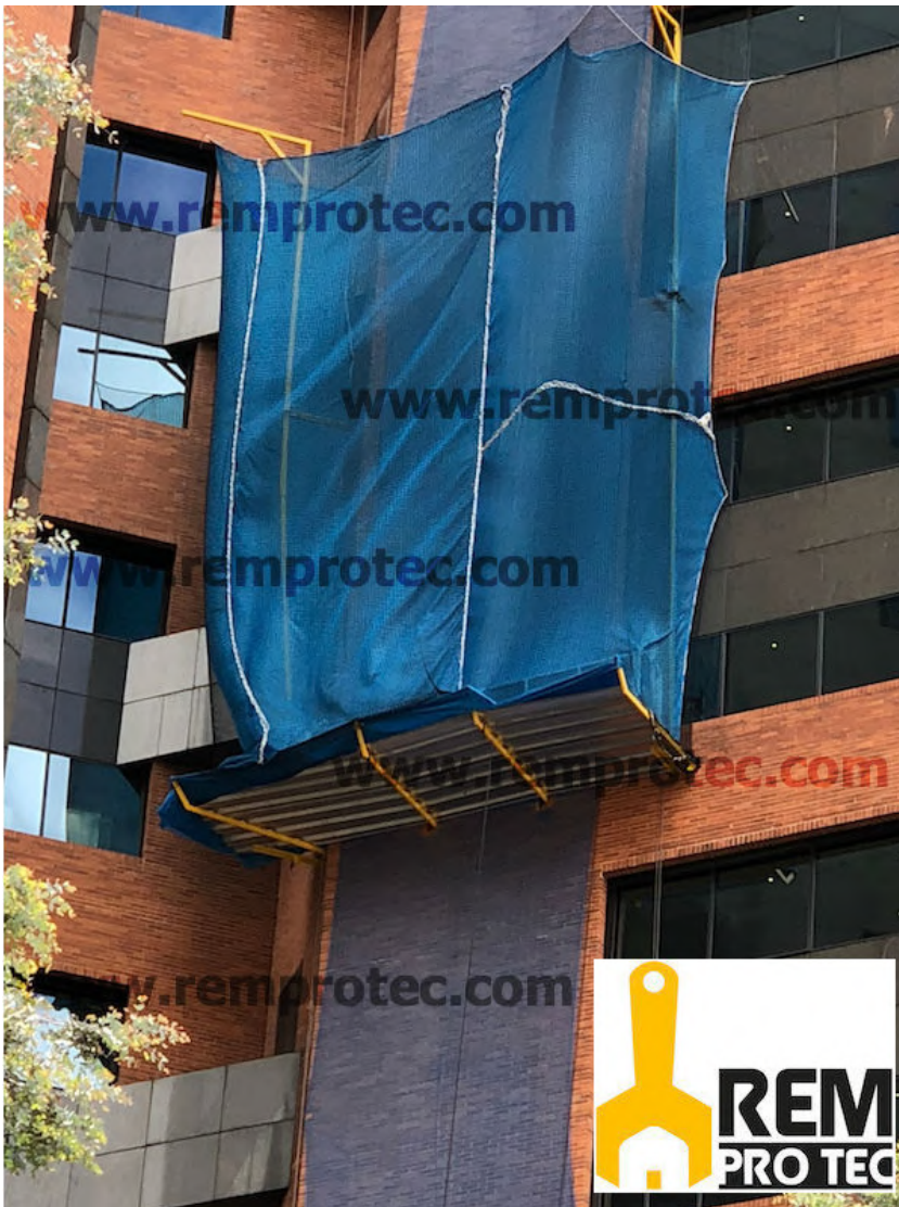
APANTALLAMIENTO DESPRENDIMIENTO DE FACHADA
