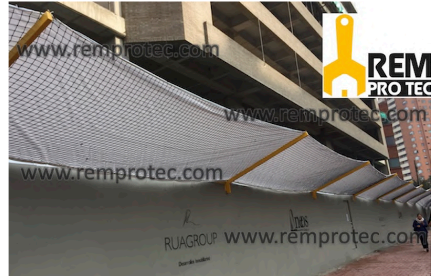
SISTEMA DE PROTECCIÓN LATERAL DE OBRA
